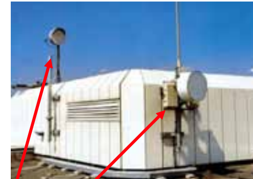
Richtfunkantennen zur Anbindung an die Vermittlungsstelle
