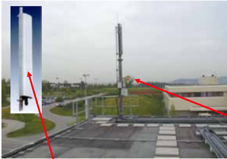
Antennen für die Zellversorgung
